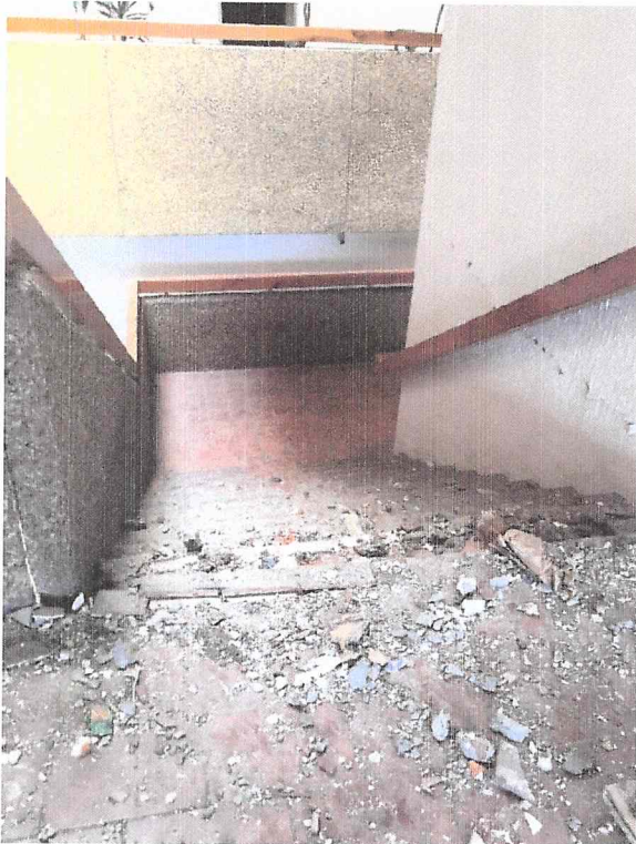
DESPRENDIMIENTO DE ESCALERA EN EL DESEMBARQUE DE LA ESTRUCTURA DE LA LOSA
