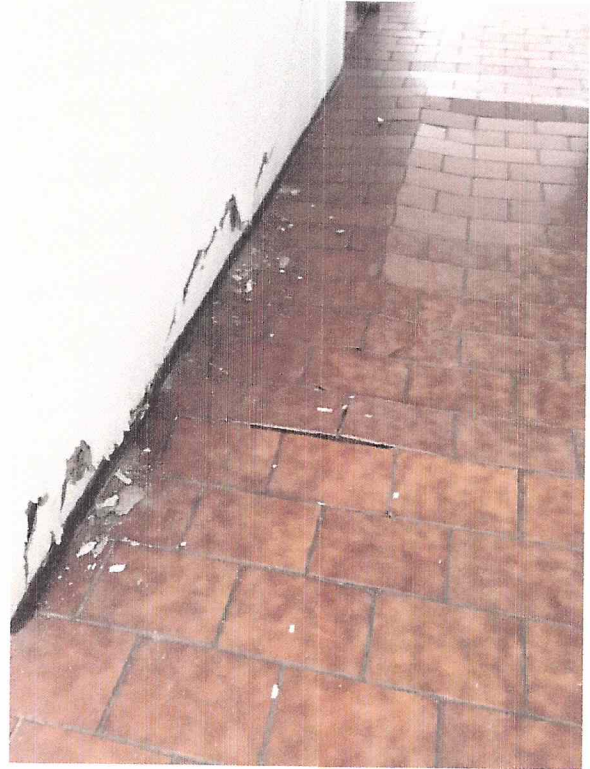
ABULTAMIENTO EN LOSA DE ENTREPISO Y AL TACTO BORDES PRONUNCIADOS
