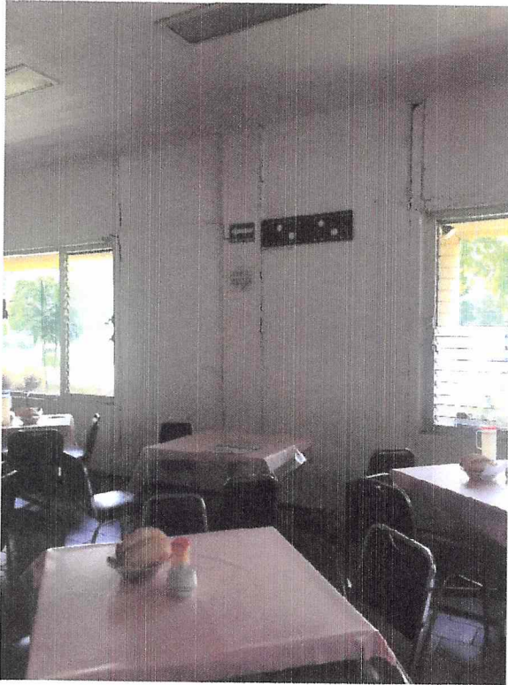
SE OBSERVAN FISURAS VERTICALES EN MUROS DE TABIQUE
