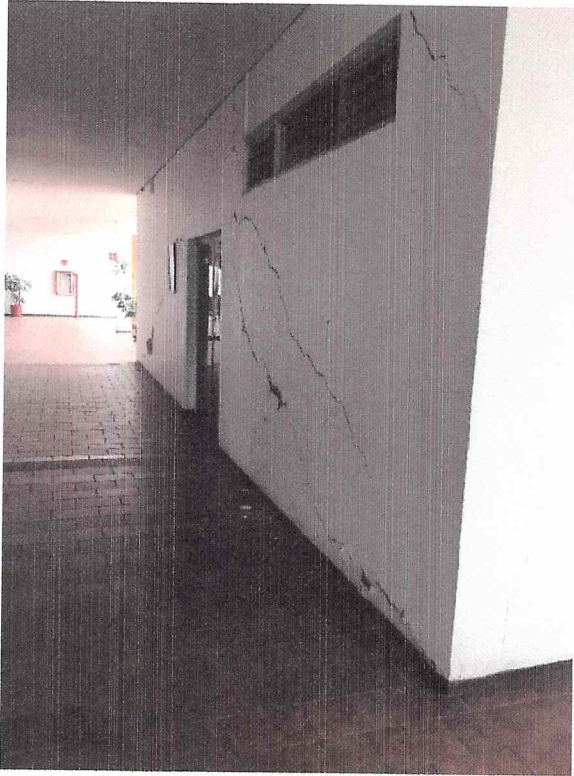
FALLAS POR CORTANTE EN MUROS DIVISORIOS DE TABIQUE
