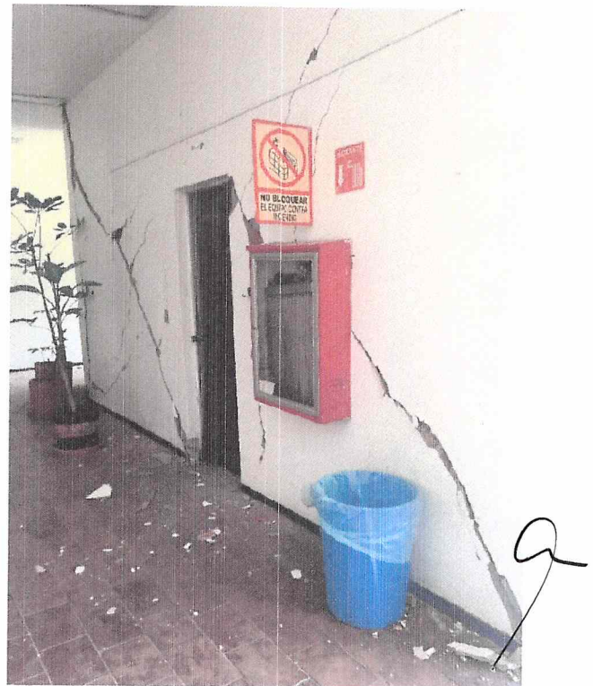
FALLAS POR CORTANTE EN MUROS DE TABIQUE
