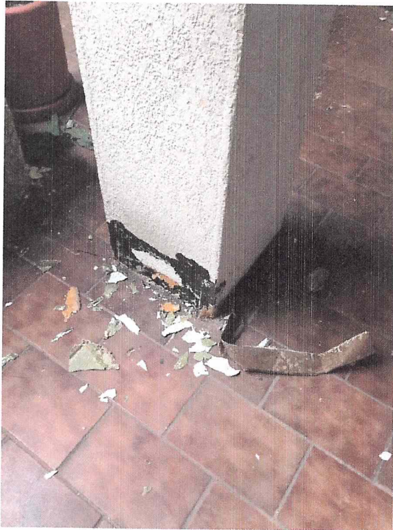
PEQUEÑA TORSION Y ABULTAMIENTO EN ESTRUCTURA EXPUESTA
