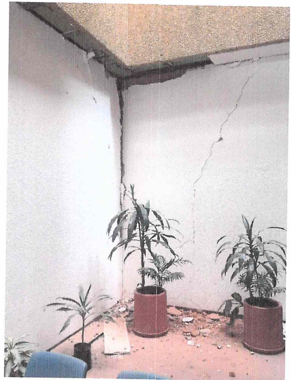
A SIMPLE VISTA SE OBSERVA QUE NO EXISTE ANCLAJE ENTRE LOS MUROS OCACIONANDO DESPRENDIMIENTO DE LA ESTRUCTURA
