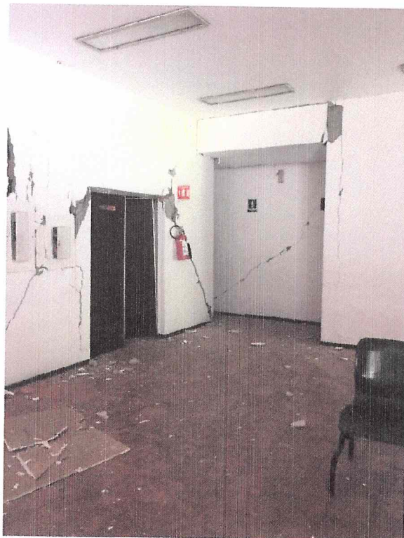
FALLAS CONSTANTES POR CORTANTE EN MUROS DE TABIQUE IMPIDIENDO LA APERTURA DE PUERTAS DE AREAS
