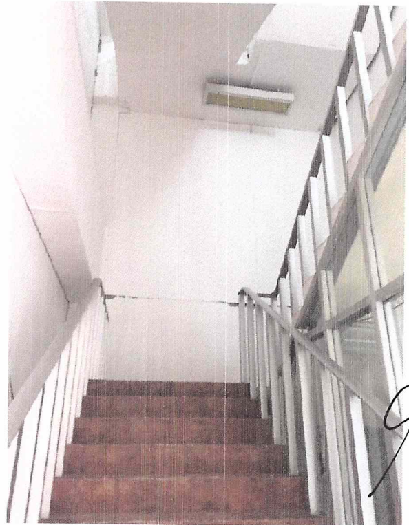
DESPRENDIMIENTO DE ACABADO Y ACUSE DE GRIETAS EN ESCALERAS DE EMERGENCIA
