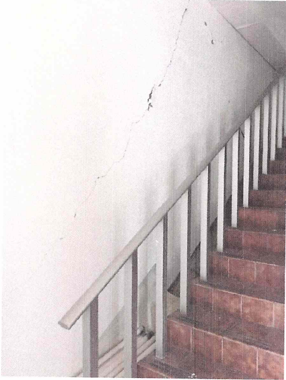
DESPRENDIMIENTO DE ACABADO Y ACUSE DE GRIETAS EN ESCALERAS DE EMERGENCIA
