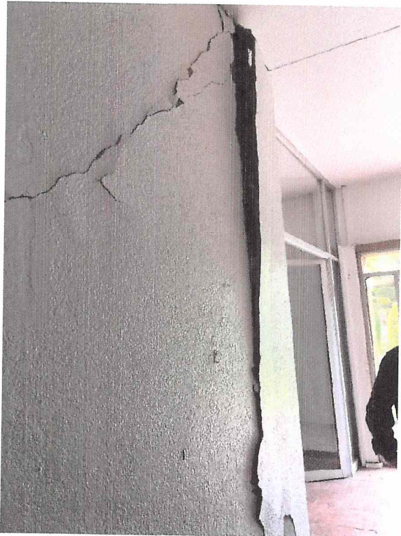
DESPRENDIMIENTO DE ACABADO Y ACUSE DE GRIETA POR CORTANTE EN MUROS DE TABIQUE
