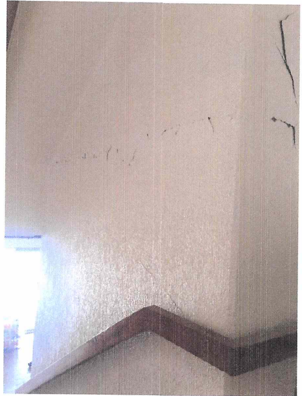
FALLA ESTRUCTURAL EN MURO DE ESTRUCTURA DE ESCALERA PRINCIPAL
