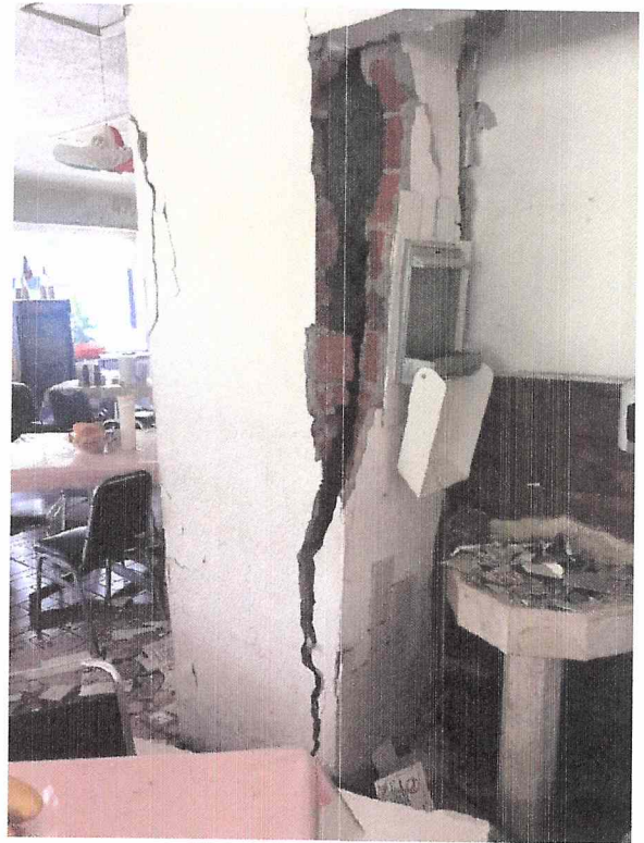
EL RECUBRIMIENTO DE LA ESTRUCTURA DESPRENDIDO
