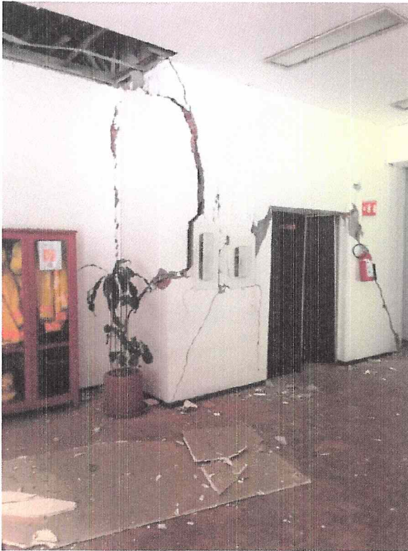
DESPRENDIMIENTO DE RECUBRIMIENTO DE ESTRUCTURA Y FALLAS POR CORTANTE EN MUROS
