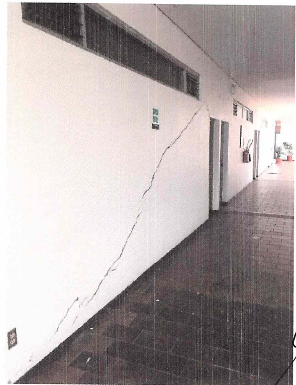
FALLAS POR CORTANTE EN MUROS DIVISORIOS DE TABIQUE
