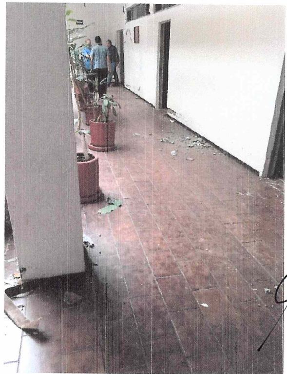
INCLINACION NOTORIA DE LA EDIFICACION
