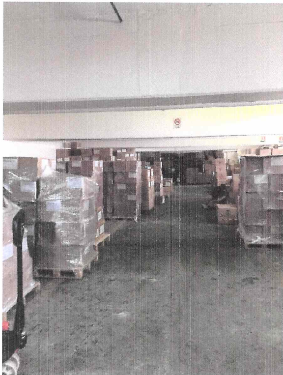
LAS VIGAS DE CONCRETO SE OBSERVAN EN BUENAS CONDICIONES SIN GRIETA ALGUNA
