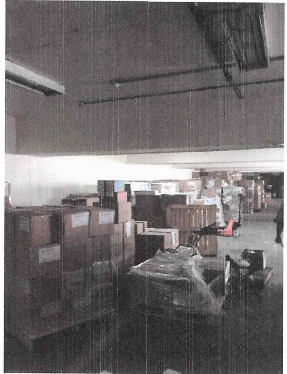
LA ESTRUCTURA PRINCIPAL DEL EDIFICIO, VIGAS Y COLUMNAS NO MUESTRAN GRIETA ALGUNA
