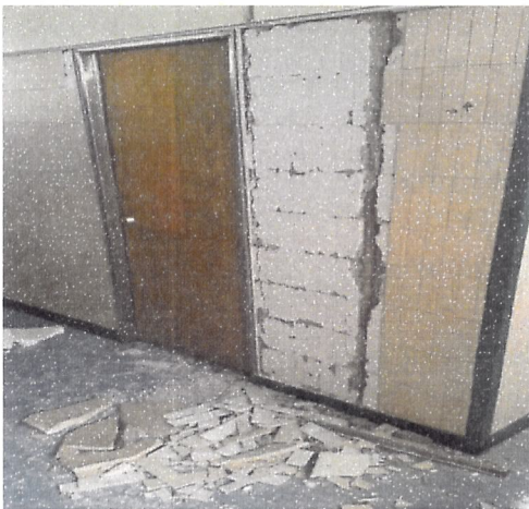
Desprendimiento de recubrimiento.
