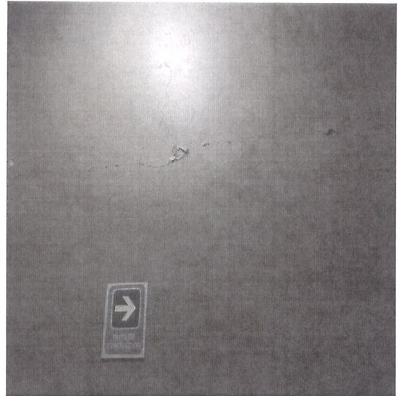
Grieta horizontal en muro de escalera .
