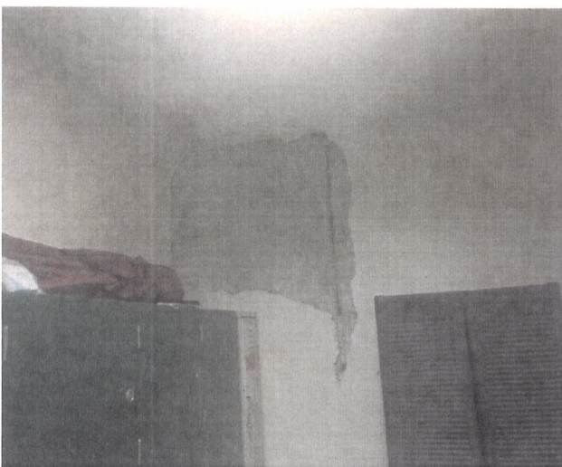
Desprendimiento de aplanado en área descanso médicos.
