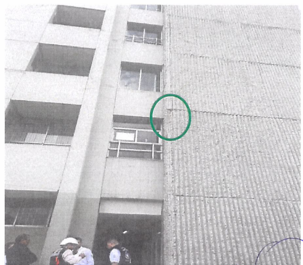
Detalle de desprendimiento de acabado en escalera de emergencia
