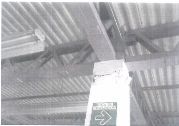
Daño en estructura metálica (columnas), se aprecia aplastamiento de parte superior.
