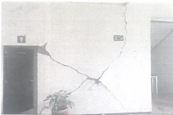
Daño estructural en muro de pasillo segundo nivel.
