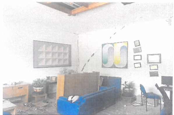
muro fisurado en oficina de director segundo nivel.
