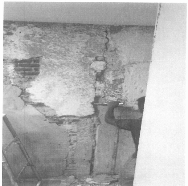
Aplanado con fisura y de junta con columna
