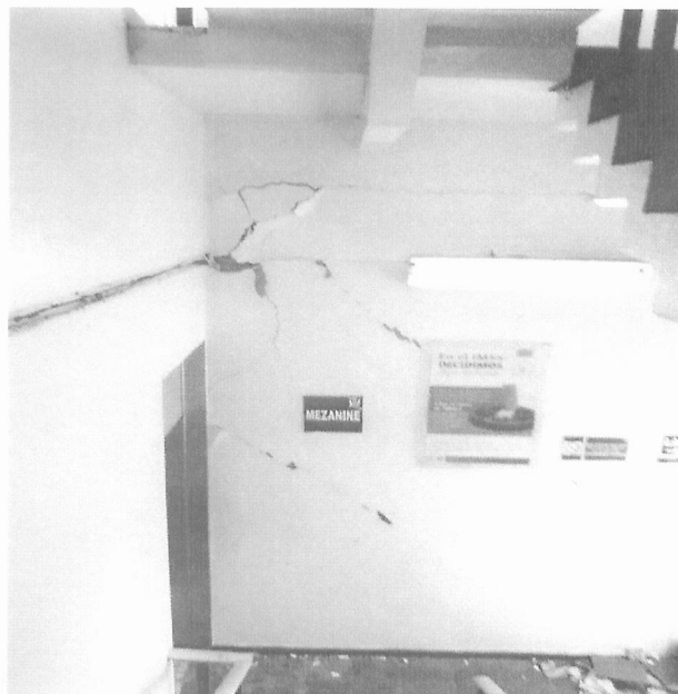
Fisuras en acabado de escalera
