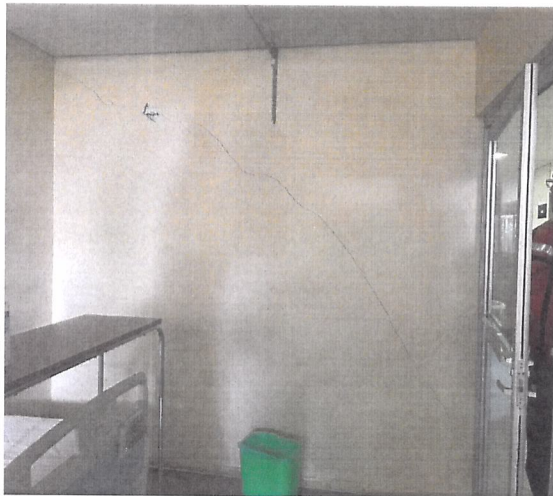
En área de hospitalización se observa desprendimiento de enjarre en muros, sin daños mayores
