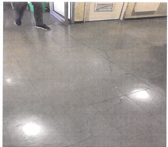
El módulo de ampliación planta baja se observa grieta de loseta vinílica y un pequeño levantamiento de piso
