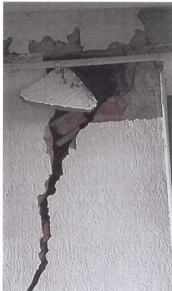
El módulo de ampliación en área de nutrición, se encontraron muros agrietados se observa que muros de tabique rojo recubren a columnas.
