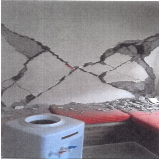
El módulo de ampliación en área de nutrición, se encontraron muros caídos y algunos otros muy agrietados
