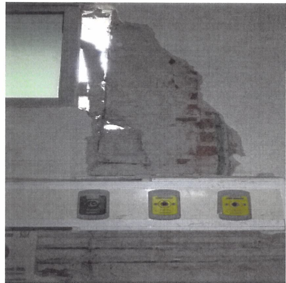
En área de encamados donde se ubican la consolas se hicieron trabajos de rehabilitación, se observa que no quitaron la instalación existente
