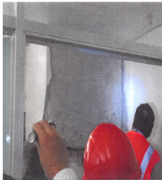
El módulo de ampliación en área de nutrición, se necesita un dictamen más profundo para dictaminar el daño en la estructura ya que es metálica recubierta de concreto
