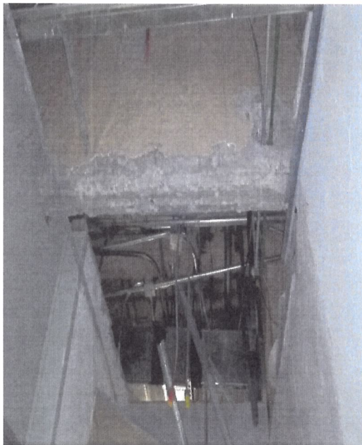
En área de Nutrición, se aprecian daños estructurales a simple vista, y se encuentra fuera de operación
