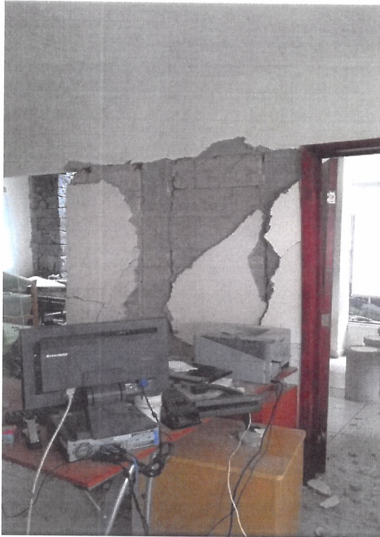
En área administrativa, se observa desprendimiento de enjarre, en muros y columna.
