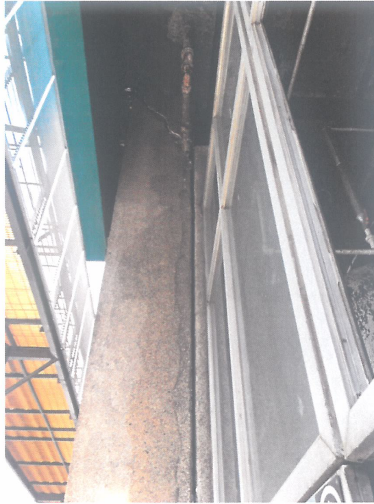
Figura 5, trabajos de albañilería que no ponen en riesgo la integridad estructural del inmueble
